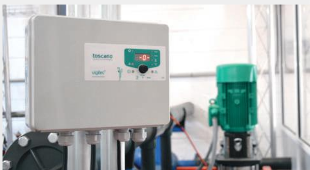
Instalaciones de bombeo
